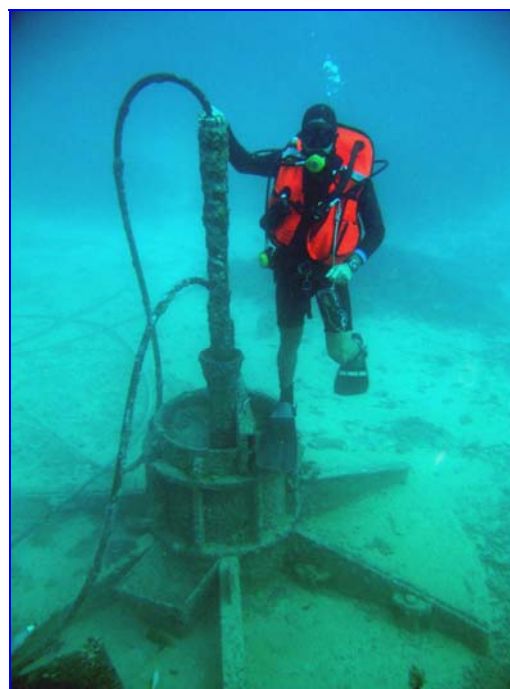
Tête de puits équipée d'un polytube
