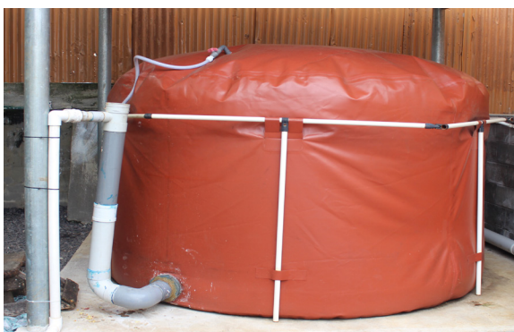
Vaitele-Fou biogas project
