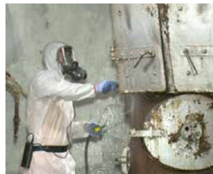
Des experts en désamiantage éliminent l'amiante de la chaudière de l'hôpital Tamavua Twomey. Photo : Amol Lal
