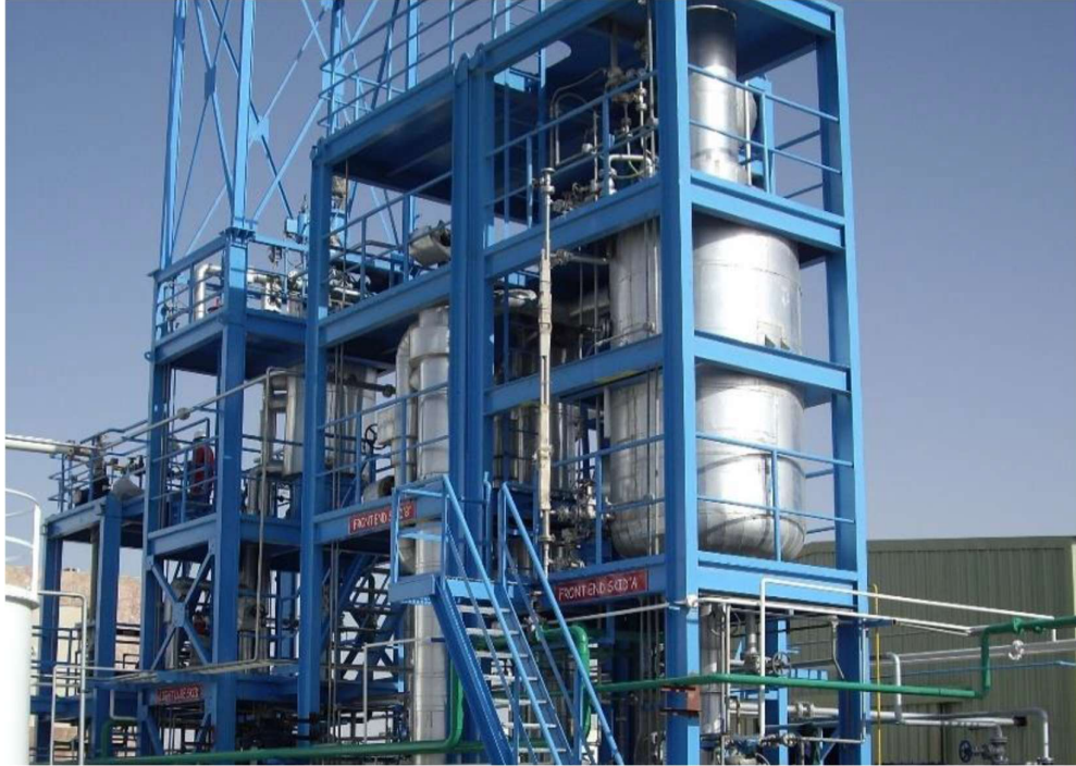
Figure 9. Usine de distillation d'huiles usagées (Allemagne) 36
