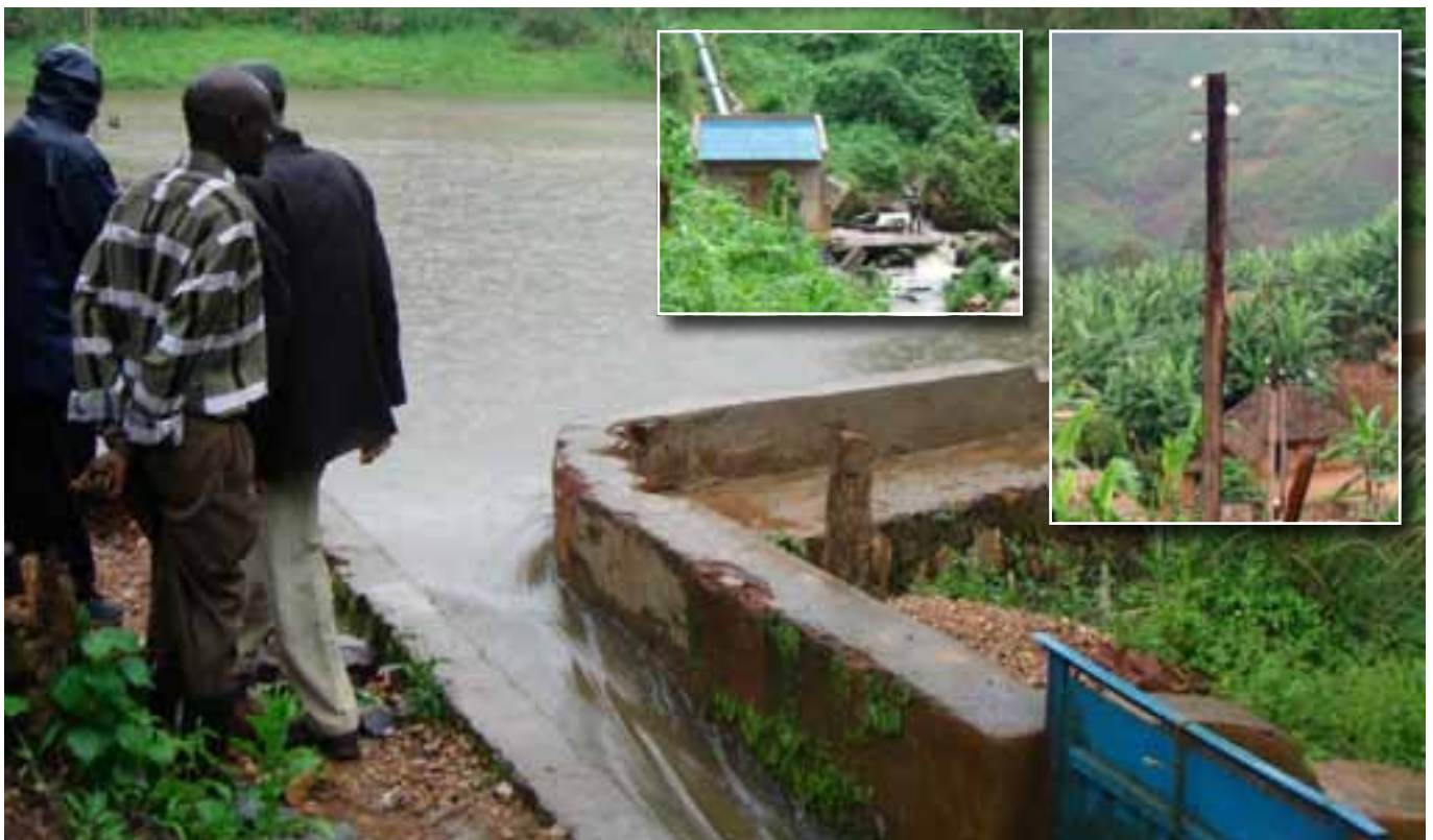
Station hydro-électrique (37 kWh) desservant le TCCB, la station de radio et le village de Kasugha. Un barrage équipé d'une vanne alimente par une conduite forcée une turbine produisant de l'électricité. De là, grâce à plusieurs transformateurs, le courant atteint le TCCB situé à plus de 4 km, et il est aussi envoyé jusqu'au village de Kasugha où il alimente l'éclairage public et plusieurs microprojets.
